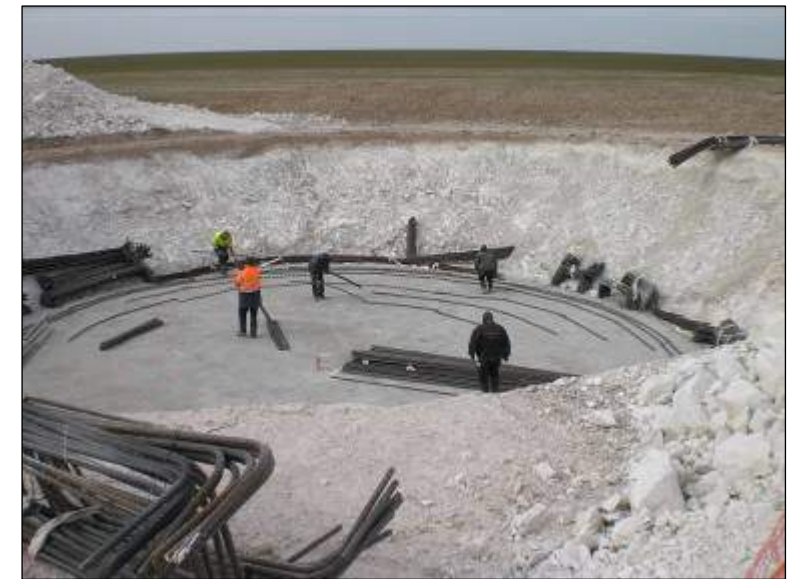
Photo 60 : Exemple de fondations à remettre en état
